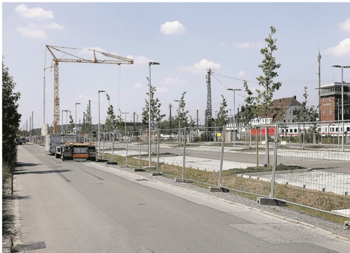
Wenn der Parkplatz auf der Rückseite des Bahnhofs fertig ist, soll die Straße „Zum Ikenkamp“ als provisorische Umgehungsstraße zur Entlastung des Verkehrs freigegeben werden.
